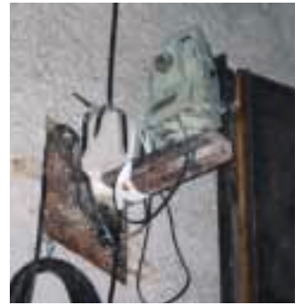
Les tachéomètres Leica TCR1105 sont montés tout en haut des parois, où ils effectuent des mesures et des contrôles
